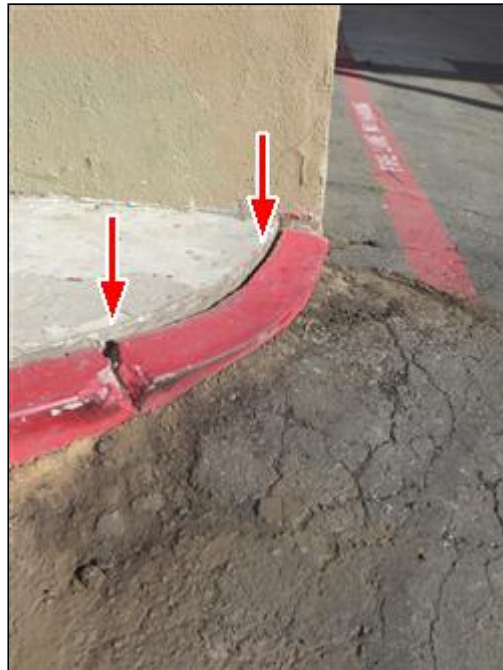
Unlevel Surfaces-Trip Hazards
